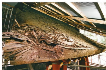
屋根葺材腐朽状況
