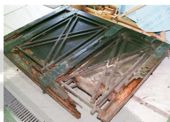
板戸 腐朽破損状況
