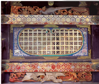
西透塀 劣化状況
